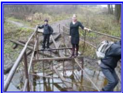
Разрушенный мост через р.Олешня
